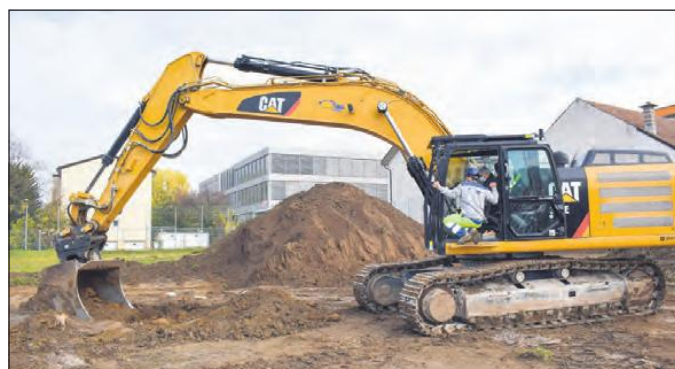
Nach dem Spatenstich nutzten die Anwesenden die Gelegenheit, einmal (unter professioneller Anleitung) die Schaufel eines grossen Baggers zu bedienen.
