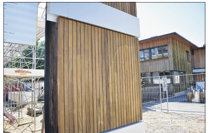
Am Rand der Baustelle steht ein Muster der Holzschalung, die das Äussere der Bauten zieren wird. Es handelt sich um druckimprägniertes Fichtenholz.
