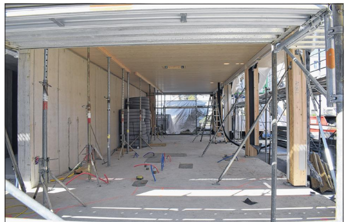
Im Erdgeschoss des Hauses B wird ein Gemeinschaftsraum entstehen. Dank Verglasung gibts einen direkten Blick in den Innenhof.
