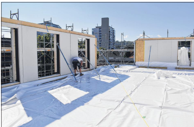
Um die Holzkonstruktion vor Regen zu schützen, muss sie bis zum Abschluss der Aufrichtung immer wieder mit Plastikplanen eingepackt werden.
